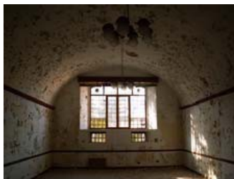
10. Uno degli enormi ambienti al primo piano; in evidenza l'avanzato degrado degli intonaci
